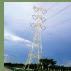
TORRES DE SUBTRANSMISIÓN Y TRANSMISIÓN
